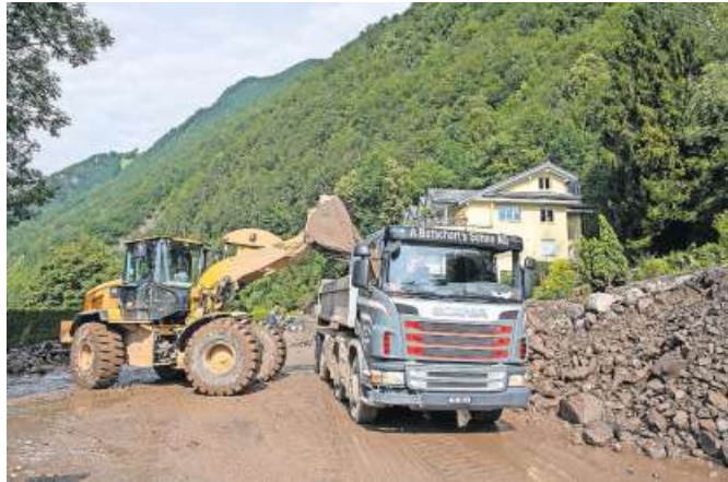
Mit schweren Baumaschinen und Lastwagen wurde gestern die Strasse geräumt. Bild: Erhard Gick
